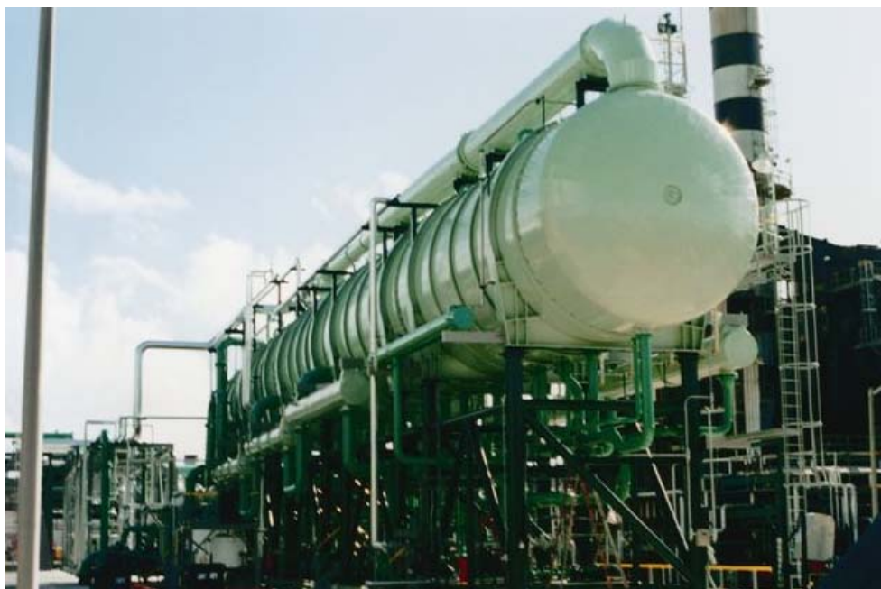
View of a MED plant
