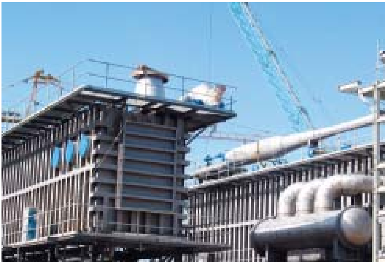
A large MED unit (Source Doosan)
